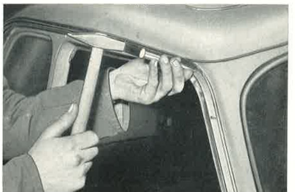
Bild 594: Die Schraubnägeln werden wieder mit dem Hammer angeheftet und mit dem Dorn eingetrieben.
