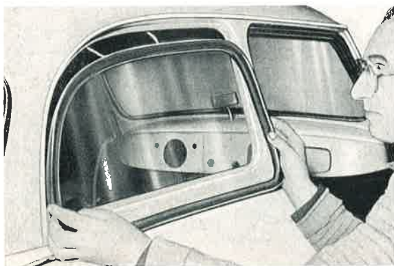
Bild 783: Die mit dem Bindfaden vorbereitete Fensterscheibe wird schräg von unten in d. Ausschnitt eingesetzt. Die Bindfadenenden kommen dabei nach innen z. liegen.
