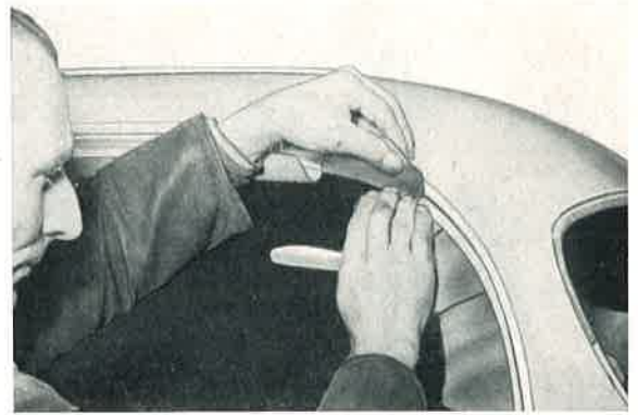
Bild 711: Hier ist jede Faltenbildung zu vermeiden, damit der Gummirahmen des Fensters dicht anschließt.
