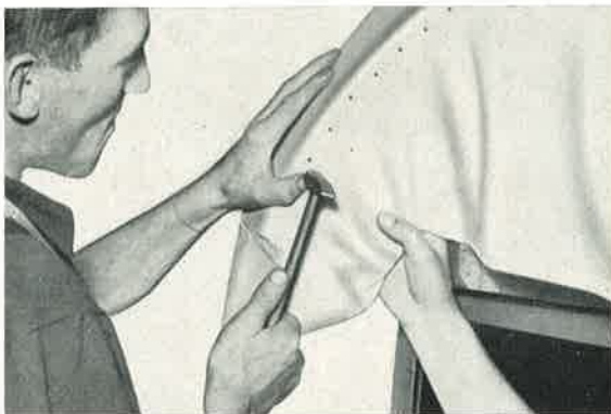
Bild 662: Während der Helfer das gespannte Stück gut unter Spannung hält, werden die Nägel eingeschlagen.
